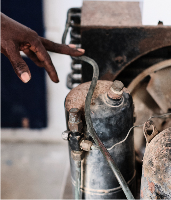
Figure 14. Équipements de réfrigération d'un établissement de l'ETFP (Photo : Lavigne, 2018)
